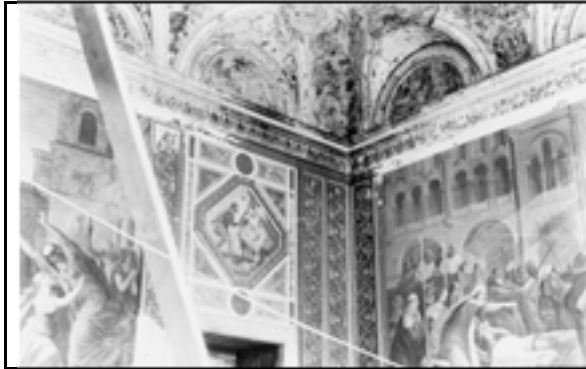
Saal des Verrats, Blick in die Nordostecke nach 1945. Gewölbe und Hauptgesims sind durch Feuchtigkeitseintrag bereits stark geschädigt.
